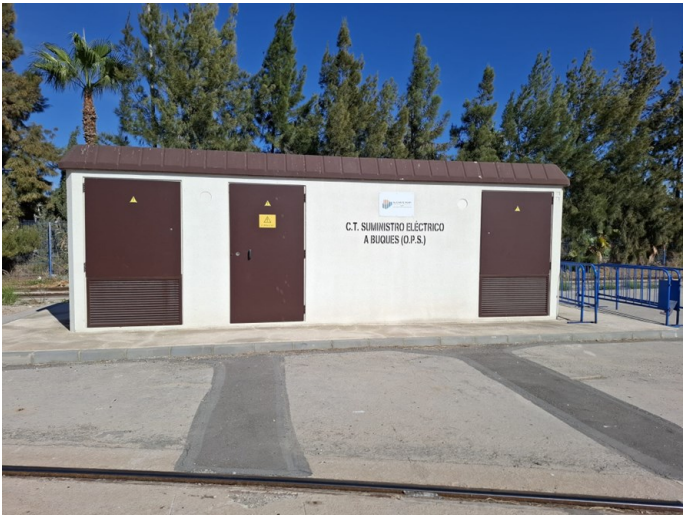
Centro de transformación de suministro a buques
