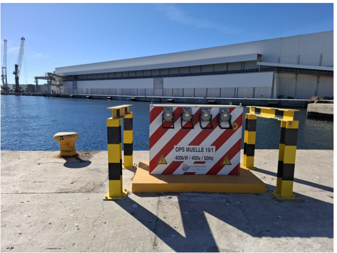
Caja de conexión de suministro a buques
