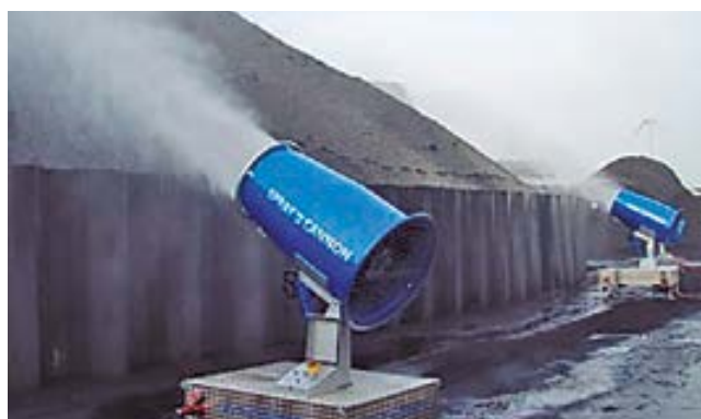
Turbinas pulverizando agua sobre acopios.
