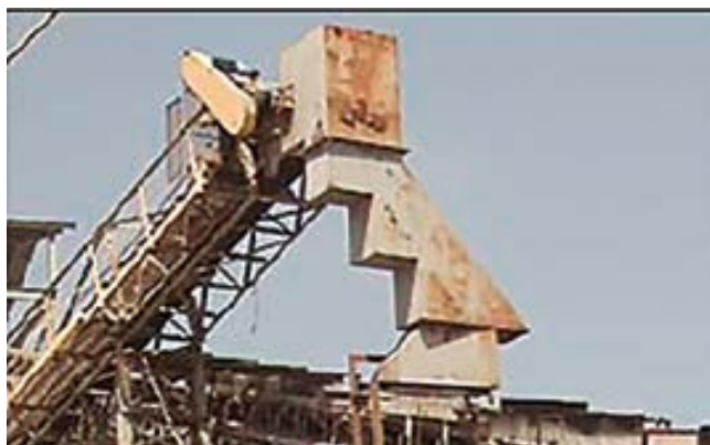
Tolva de transferencia en escalera
