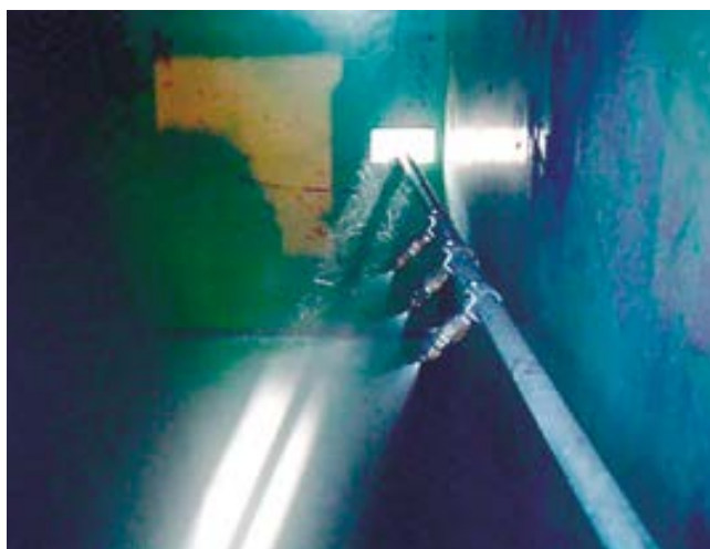
Pulverización de agua con inyectores
