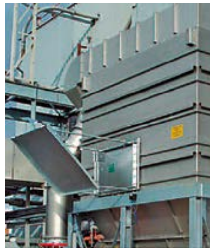
Panel de rotura y deflector en filtro
