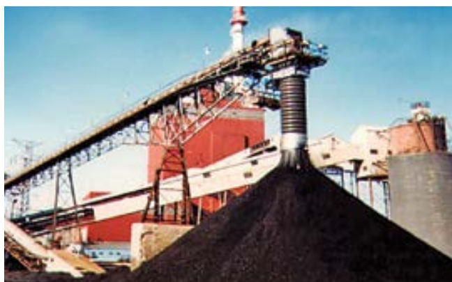
Formación de acopio mediante tolva telescópica cubierta.
