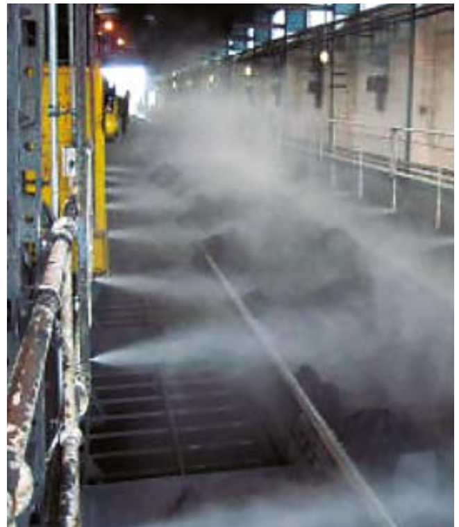
Descargador de vagones con nebulización de agua.
