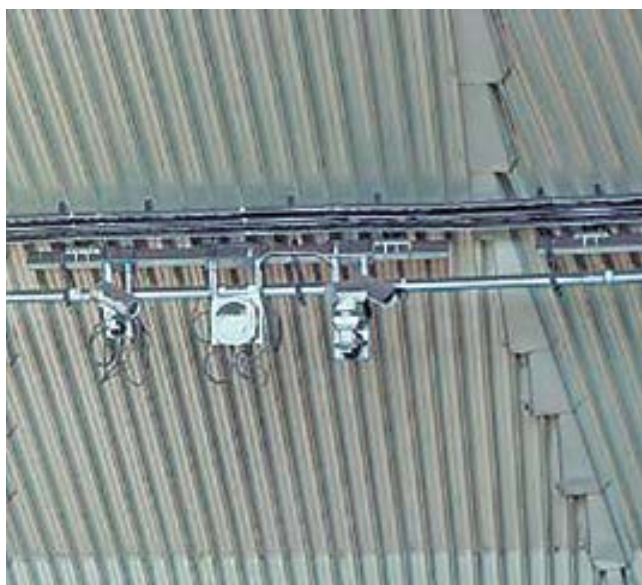
Cámaras termográficas informan de posibles autocombustiones.
