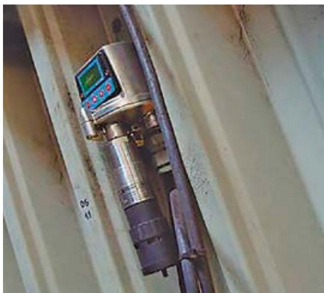
Detectores de gases combustibles.
