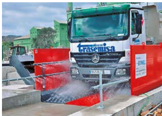
Sistema lavaruedas en funcionamiento
