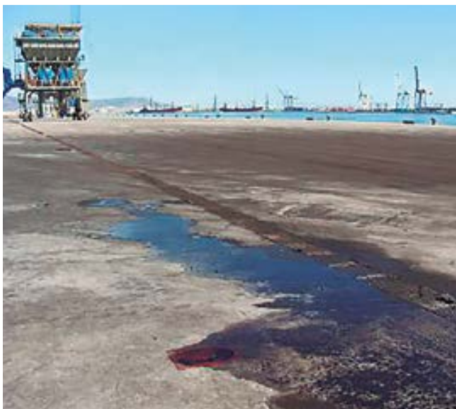
Drenajes cegados por restos de mercancía
